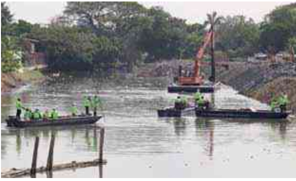
พนงงาน กทม. ขุดลอกคลองบางเขน มขุดลอกคลองเป็นมาตรการหนึ่งในการป้องกันน้ำท่วม Workers of the Bangkok Metropolitan Administration are dredging Bang Khen canal. Canal dredging is one of the many measures to prevent flood
